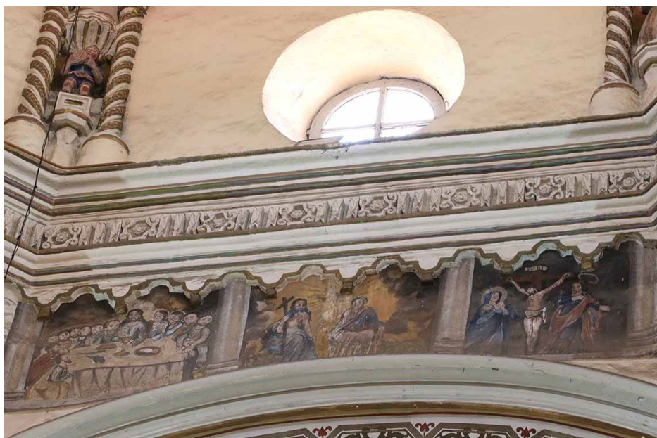
Fig. 16. Escenas repintadas de la Última Cena, la Trinidad y la Crucifixión, en el extremo oriente de la base del tambor de la cúpula. Más arriba se observa una achaparrada figura con una concha (probablemente Santiago) en un nicho entre dos columnas "salomónicas" pintadas en blanco y dorado.
